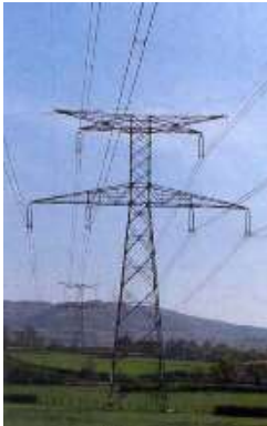
Pylône très haute tension (RTE)
